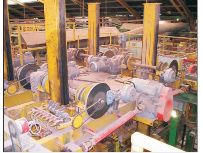
Tuğla Fabrikası Acil Stop Uygulaması
